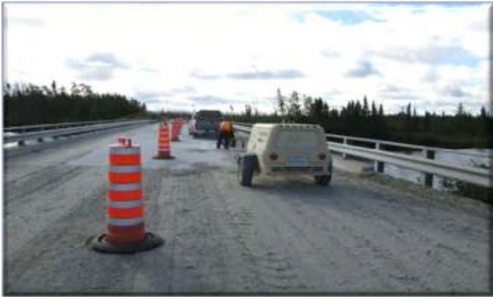
🚧 Installation des équipements pour le découpage de la dalle (vue vers l'est) et signalisation
