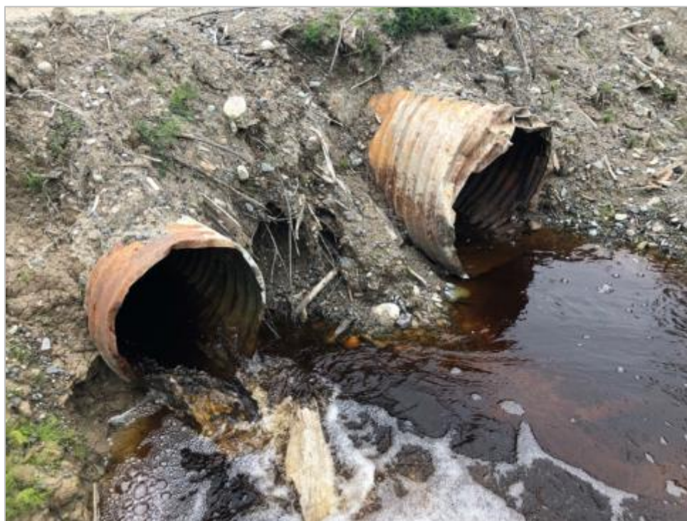
Figure 8.5-96 : Ponceaux en TTO existants de 1 000 mm et 600 mm de diamètre traversant la plateforme Grevet-Chapais au PK 164.1 (Les ponceaux sont rouillés et légèrement cabossés, mais semblent fonctionnels)
