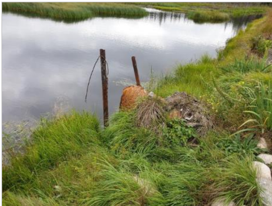
Figure 8.5-95 : Ponceau en TTO existant de 600 mm de diamètre traversant la plateforme Grevet-Chapais au PK 132.0 (Le ponceau est rouillé, mais semble fonctionnel)
