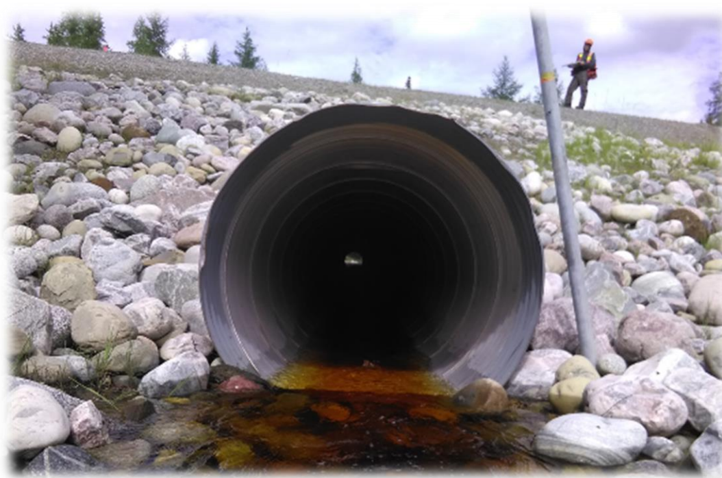
Figure 8.7-10 : Site avec manque de glissière au droit d'un ponceau
