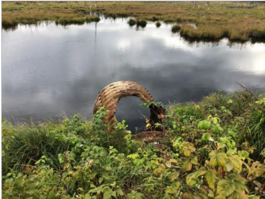
Figure 8.5-97 : Ponceau en TTO existant de \pm 1\ 500 mm de diamètre traversant la plateforme Grevet-Chapais au PK 220.1 (Le ponceau est rouillé et brisé)
